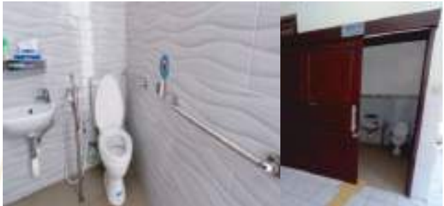
Gambar : Toilet disabilitas pada Pengadilan Negeri Singaraja
